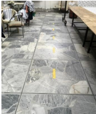
Figura 58. Señalética deteriorada en área de confección.
