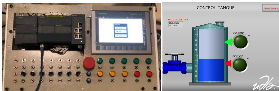
Figura 94. Tanque sin alarma por tener la cantidad media.
