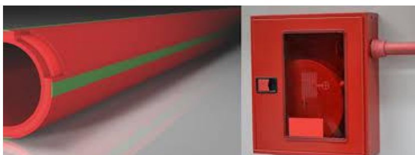
Figura 55. Sistema Contra incendios en Centro cultural
