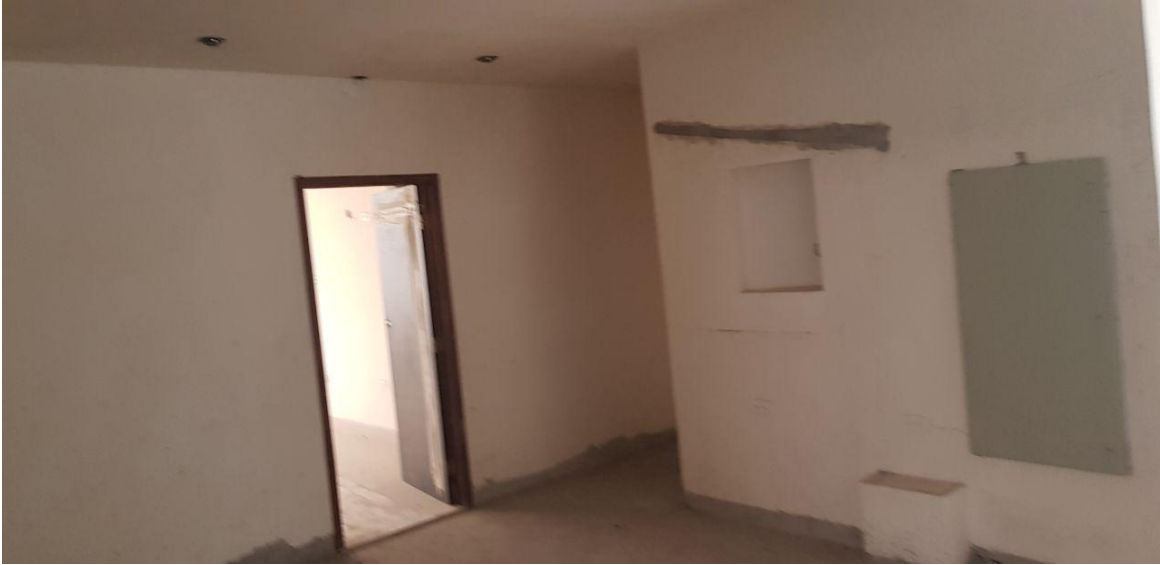
Figura 42. Sala del tercer piso Hotel King David.
