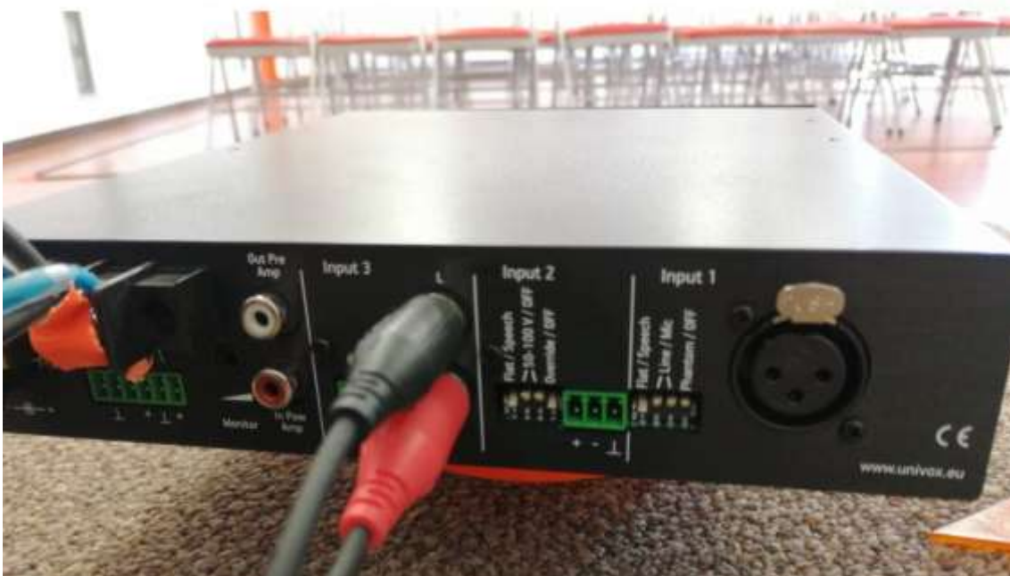
Colocación de cables RCA que van de la consola hacia el amplificador.
