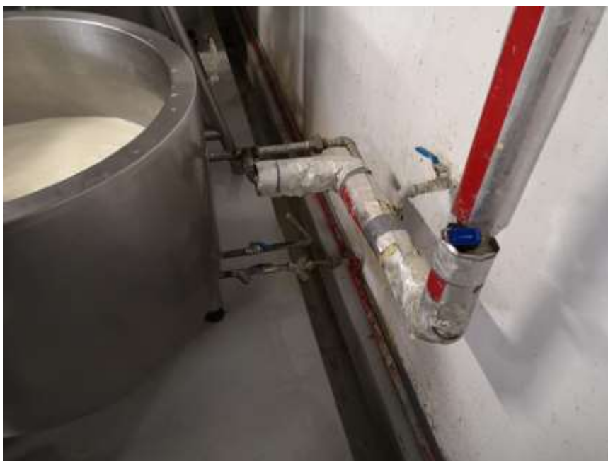
Figura 55. Conexión de la tubería del caldero hacia máquina Granja 2 UDLA.
