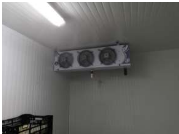
Figura 54. Ventilador y su conexión Granja 2 UDLA.
