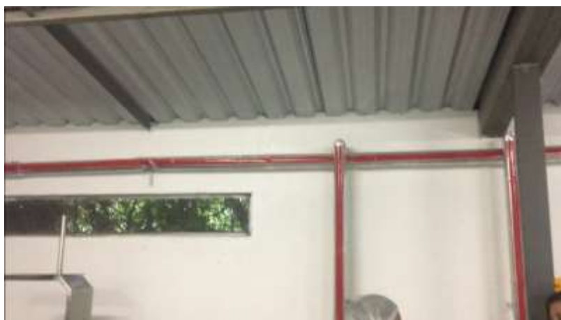
Figura 57. Conexión de la tubería del caldero hacía el cuarto de procesamiento de lácteos Granja 2 UDLA.
