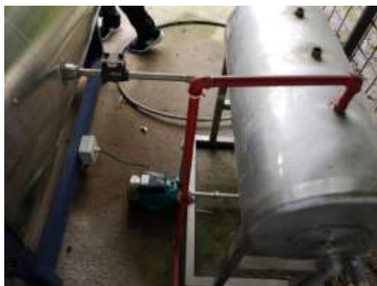
Figura 53. Caldero y sus conexiones Granja 2 UDLA.
