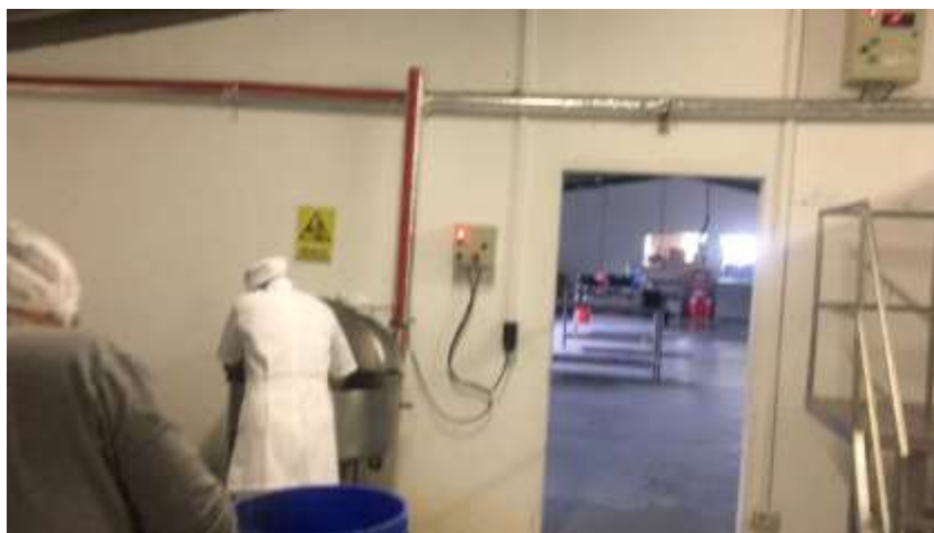
Figura 56. Conexión de la tubería del caldero hacía el cuarto de procesamiento de lácteos Granja 2 UDLA.
