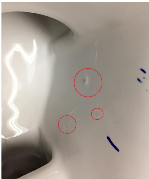
Figura 57. Defecto 22 en zona 24
