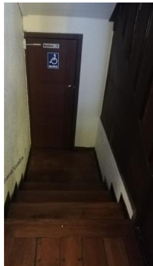
Figura 8: EDIFICACIÓN ANTIGUA CON BARRERAS ARQUITECTONICAS
