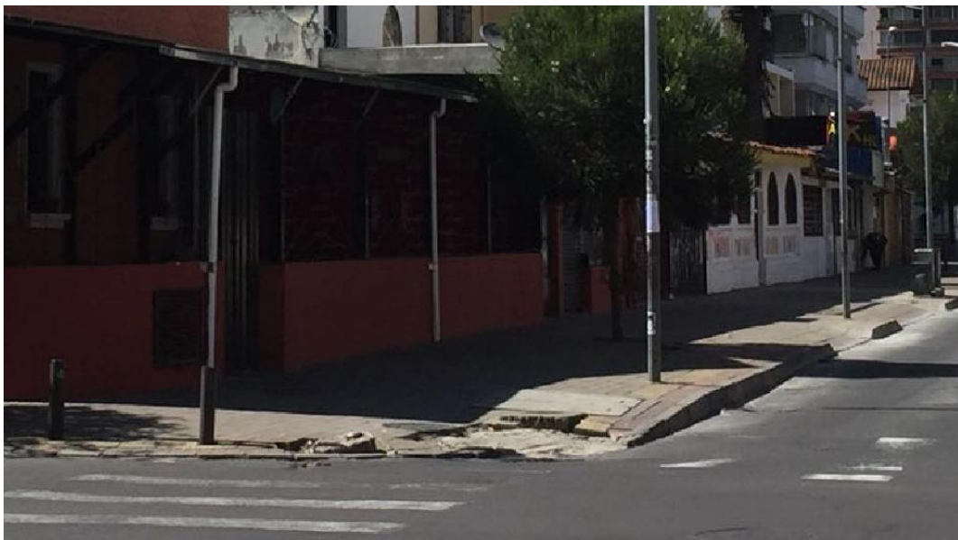
Figura No 11: Estado actual de aceras en La Mariscal
