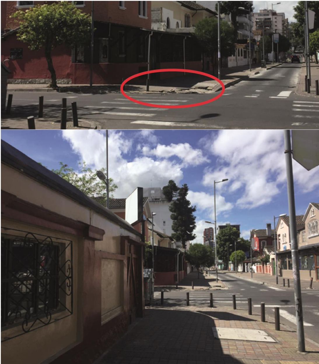
Figura No 5: Bolardos en las esquinas de cruces de una acera hacia otra y mal estado en las esquinas.
