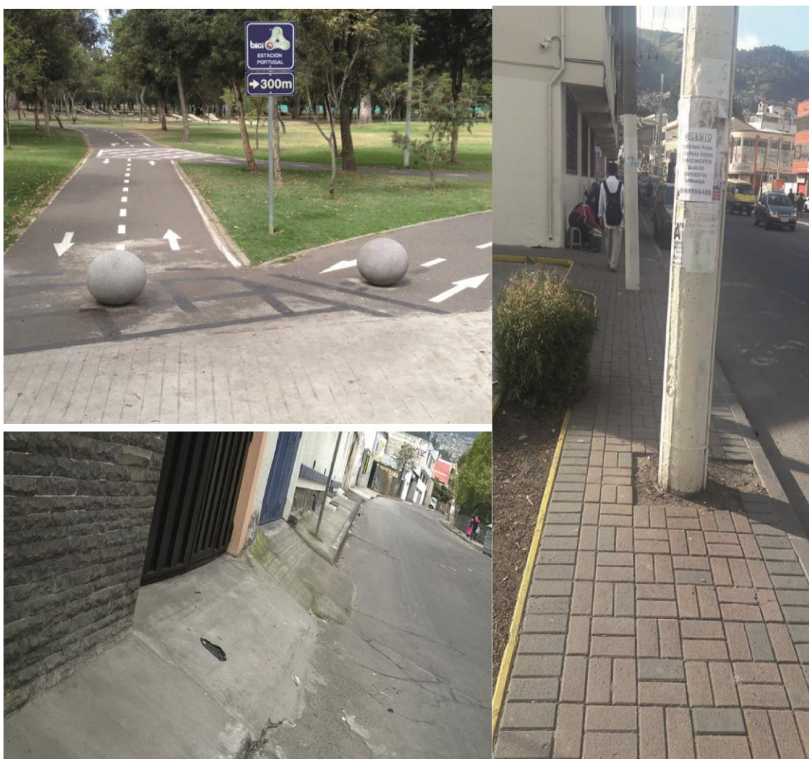
Figura No 21: Obra civil realizada de una forma incorrecta.
