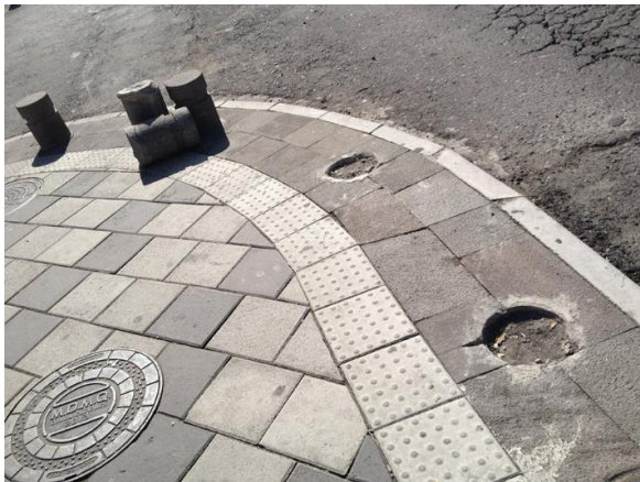
Figura 1: RETIRO DE ALCORQUES DE HORMIGON QUE IMPEDIAN EL CRUCE EN SILLA DE RUEDAS
