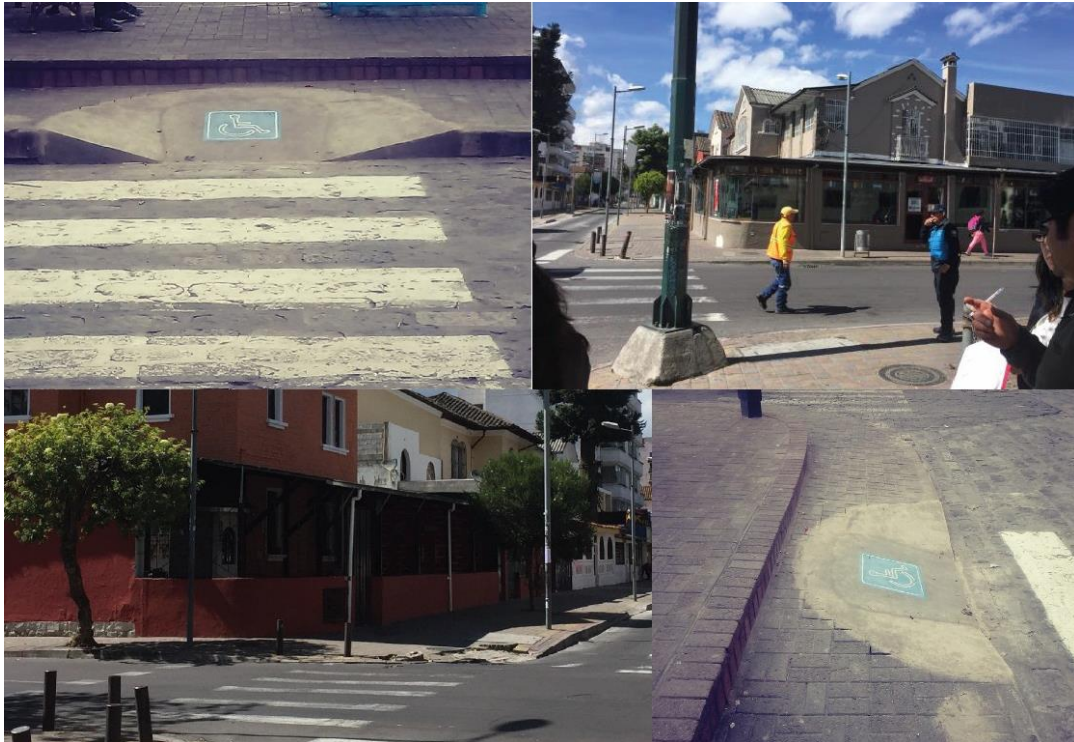
Figura No 37: Obras con mala ejecución La Mariscal.
