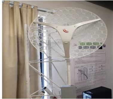
Figura 25. Estructura de radioenlace
