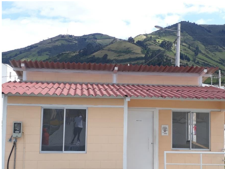
Figura 47. Cubierta actual en vivienda. Tomado de: Autor. Maruri Esteban.
