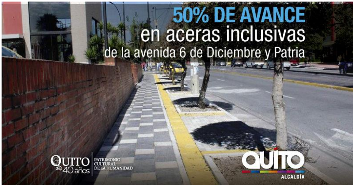
Figura 2. Aceras y estaciones con adoquines podo táctiles.
