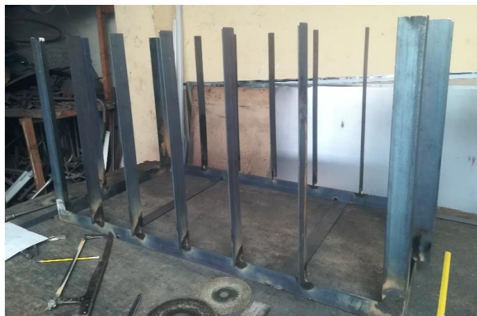
Figura 23. Fotografía de la construcción de la parte superior de soporte para los tanques floculadores.
