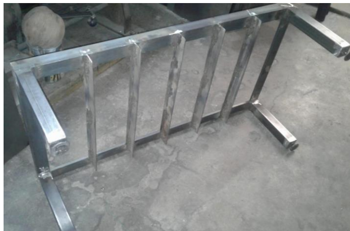
Figura 22. Fotografía de la construcción de la base de soporte para los tanques floculadores.
