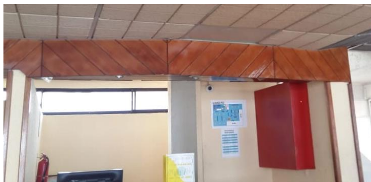
Figura 104. Caja de emergencia y extintores.
