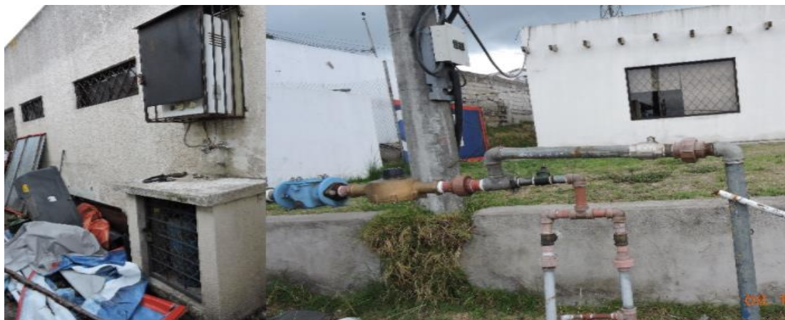
Figura 83. Instalaciones eléctrica - Red principal de agua
