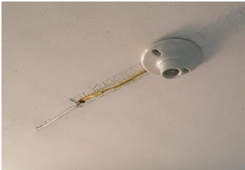
Figura 79. Instalación eléctrica expuesta
