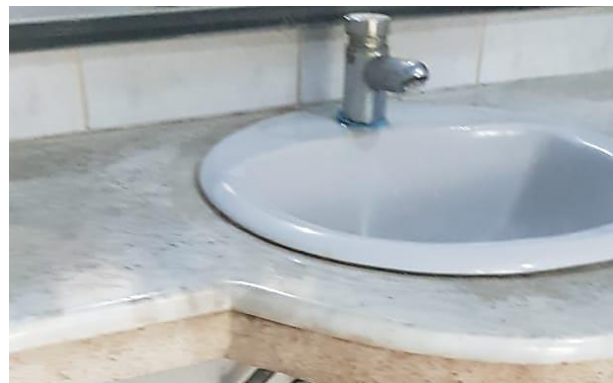
Figura 76. Lavamanos de baños
