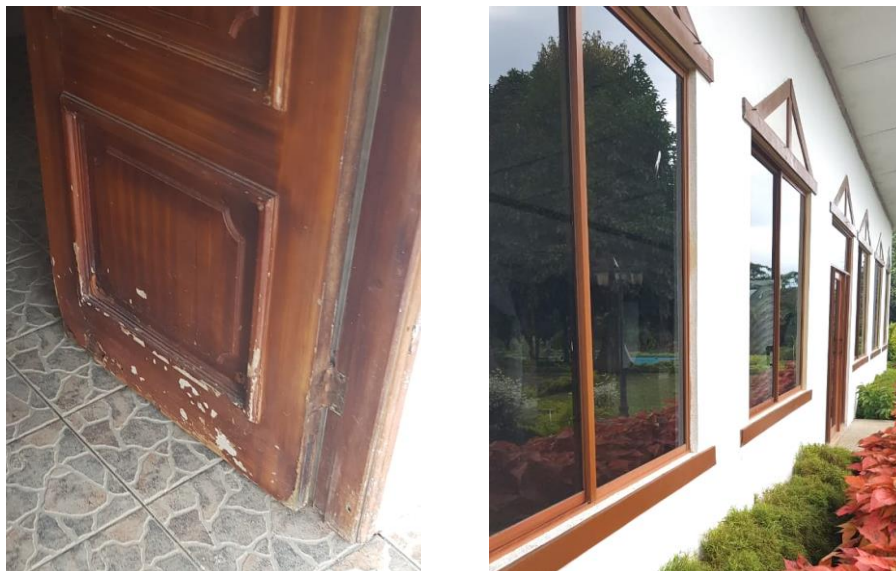
Figura 75. Puertas y ventanas
