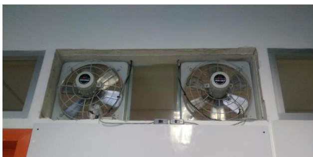
Figura 17: Inconformidad literal c, extractores de aire sin protección.
