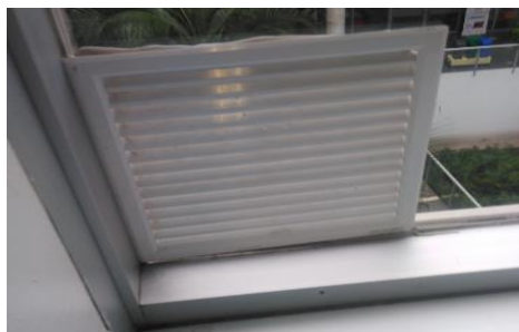
Figura 18: Inconformidad literal d, ventilación sin protección.
