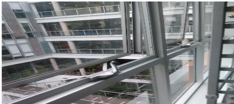
Figura 7: No conformidad literal a, sin protección del exterior.
