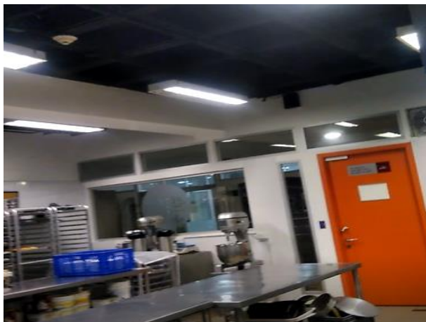
Figura 16: Luminarias sobre mesas de trabajo sin protección.
