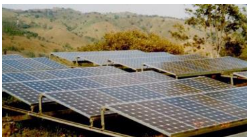
Figura 1. Paneles solares. Tomado de (CELEC EP)
