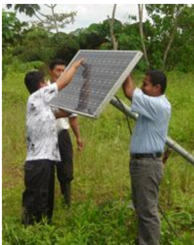
Figura 2. Instalación de paneles solares para un sistema fotovoltaico de energía. Tomado de (CELEC EP)
