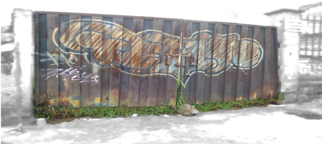
Figura 110. Ejemplo de Puerta Oxidada.
