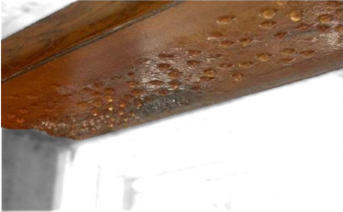
Figura 89. Humedad por Condensación. Tomada de (Mendez, S/F).
