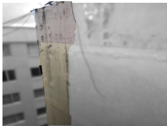
Figura 82. Ensuciamiento por lavado diferencial
