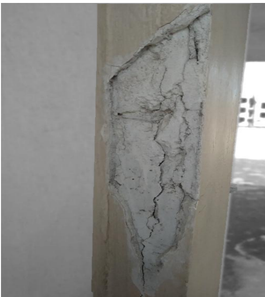
Figura 97. Desprendimiento y agrietamiento.
