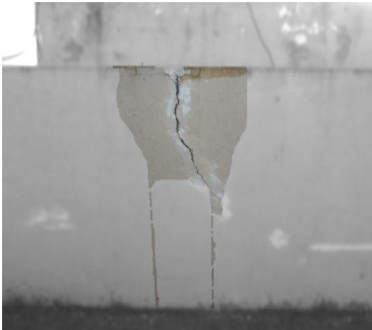
Figura 92. Ejemplo de Grieta.
