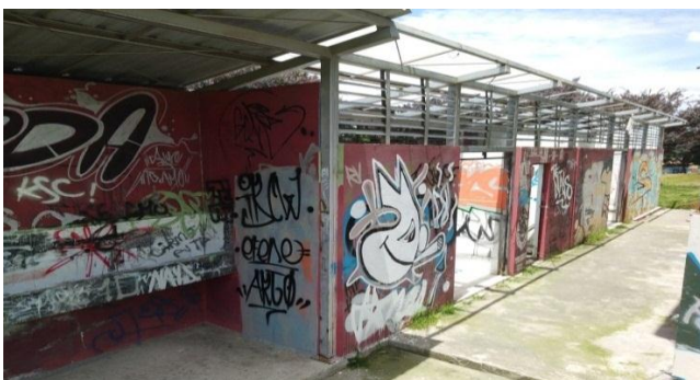
Figura 129. Baños abandonados en la parte trasera de la Concha Acústica.
