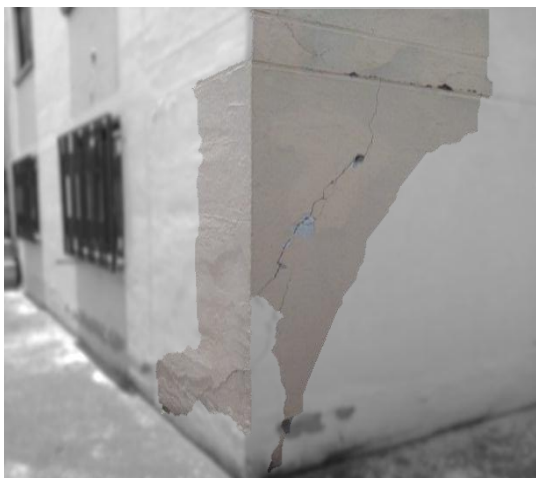
Figura 94. Ejemplo de fisura.
