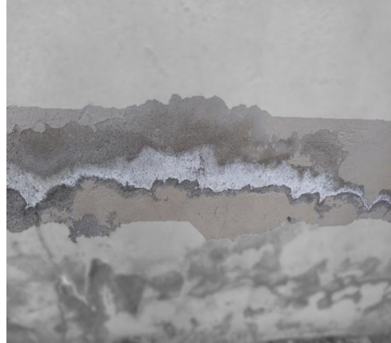
Figura 107. Eflorescencia en pared.
