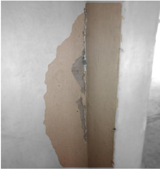
Figura 90. Ejemplo de Fisura.
