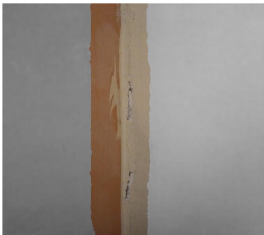
Figura 95. Ejemplo de Fisuras.
