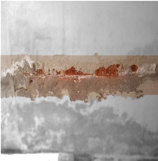
Figura 104. Erosión en una pared.
