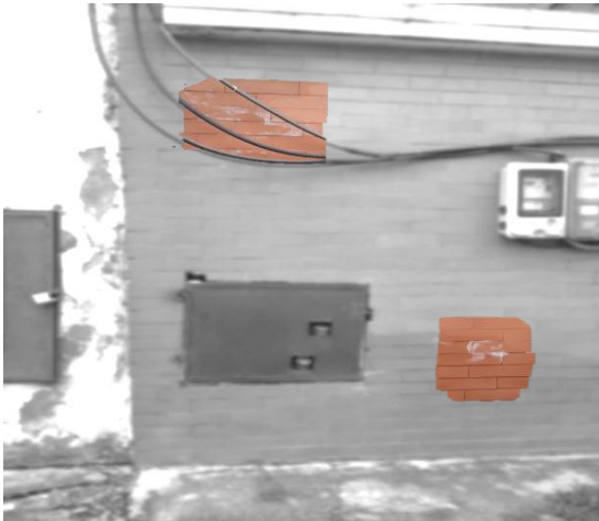
Figura 106. Eflorescencia en fachaleta.
