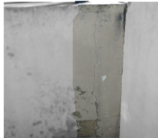
Figura 93. Ejemplo de fisura.
