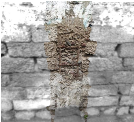
Figura 108. Corrosión en hierro.
