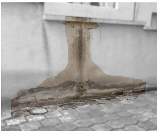
Figura 83. Ensuciamiento por lavado diferencial.
