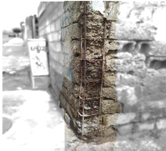
Figura 109. Corrosión en hierro.
