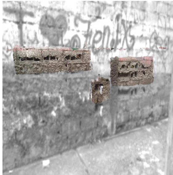
Figura 105. Erosión en una pared.
