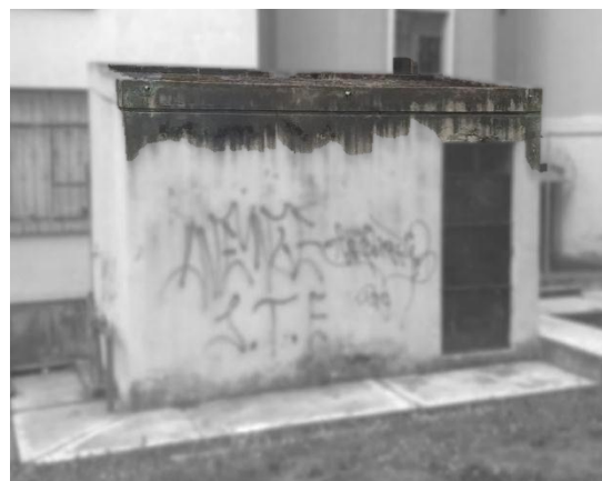
Figura 84. Ensuciamiento por lavado diferencial.
