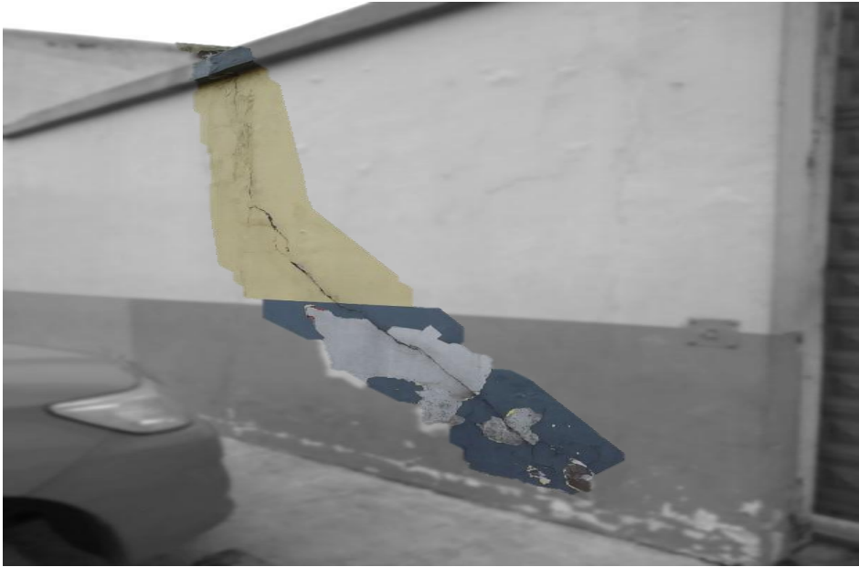
Figura 96. Ejemplo de Grieta.
