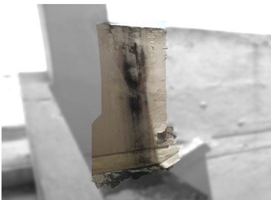
Figura 81. Ensuciamiento por lavado diferencial
