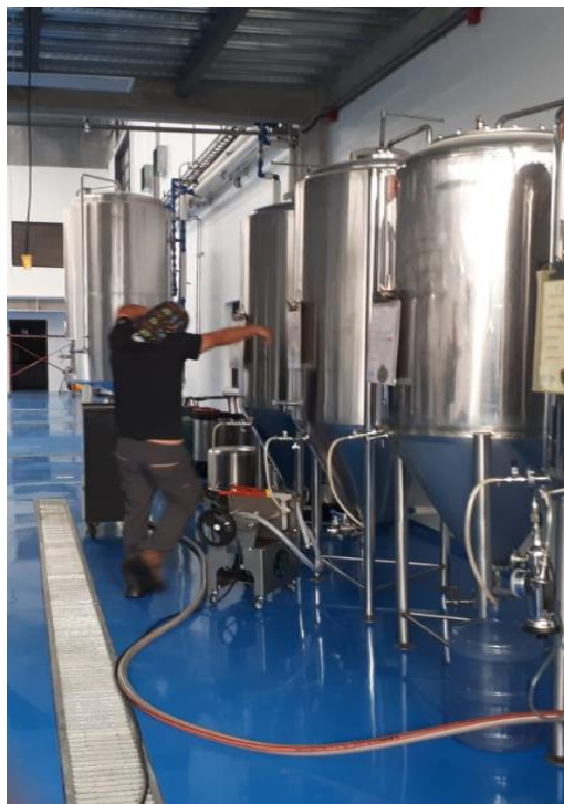
Figura 7. Área de fermentadores, colaborador despresurizando tanques, Santana Brewing Company S.A.
