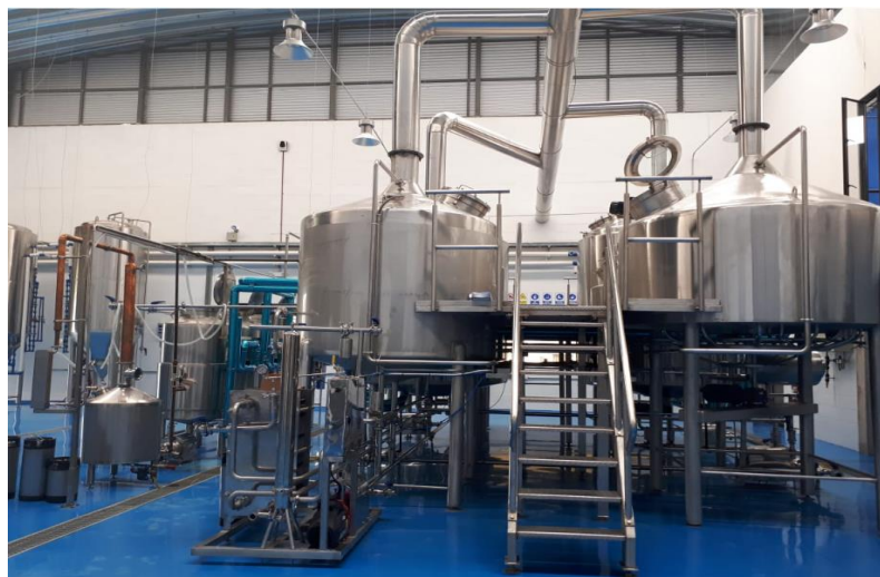
Figura 6. Sala de cocción mayor, Santana Brewing Company S.A.
