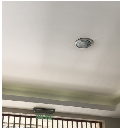
Figura 66. Cielo Raso de Gypsum.
