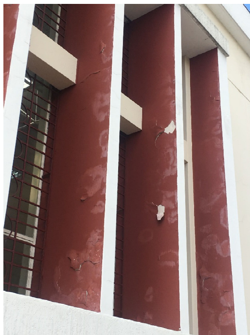
Figura 60. Deterioro en Fachada por Filtraciones de Agua.
