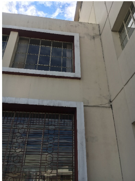
Figura 62. Deterioro en Fachada Norte.
