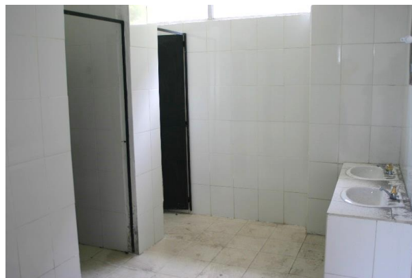
Figura 76. Instalaciones sanitarias de la antigua escuela Intiraymi
