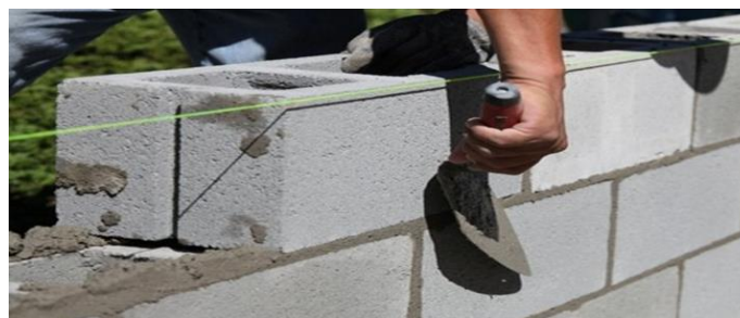
Figura 27. Colocación de los bloques en la posición correcta Tomado de: (Herrera & Madrid, 2001)
