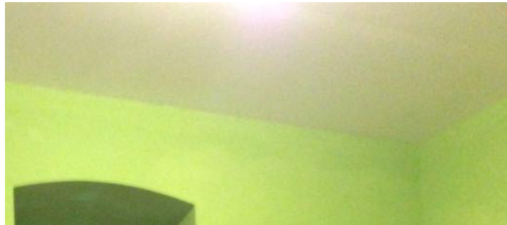
Figura 54. Estado de cielos rasos enlucidos y pintados en habitaciones de planta baja
