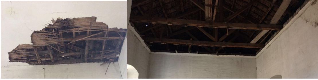
Figura 53. Estado de cielos rasos de carrizo y barro en habitaciones superiores.
