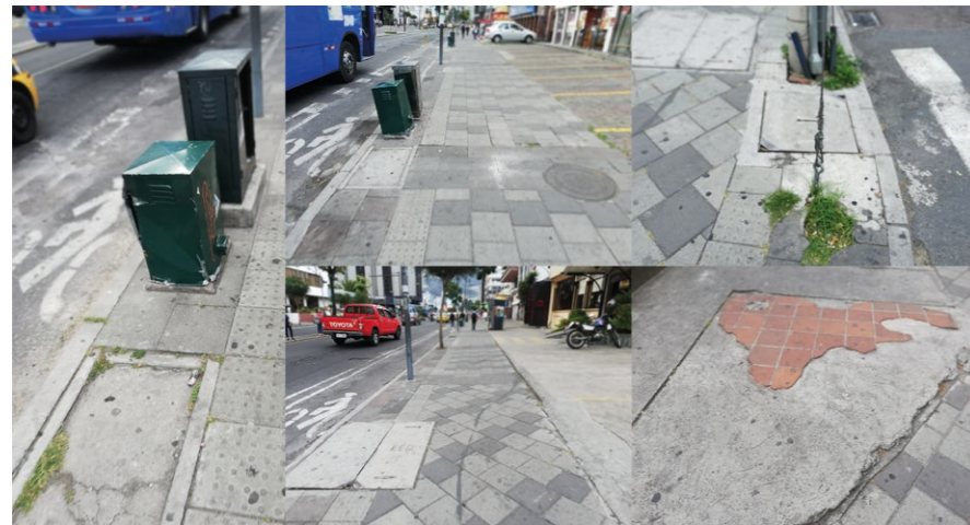
Figura 92. Imágenes del espacio público cercano al terreno y su deterioro.
