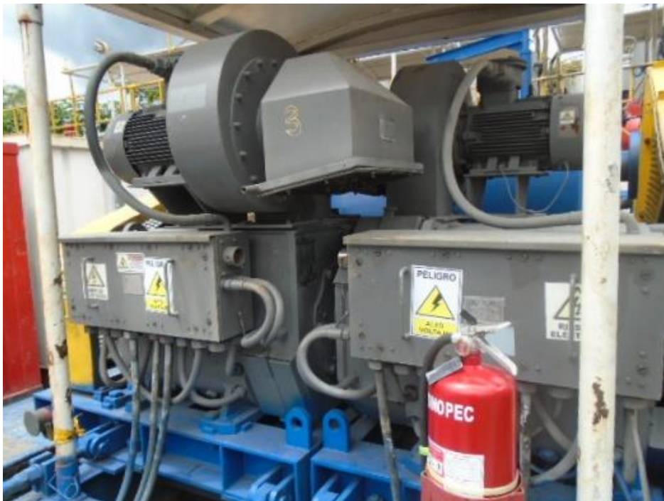
Figura 3. Motores eléctricos DC de un taladro de perforación
