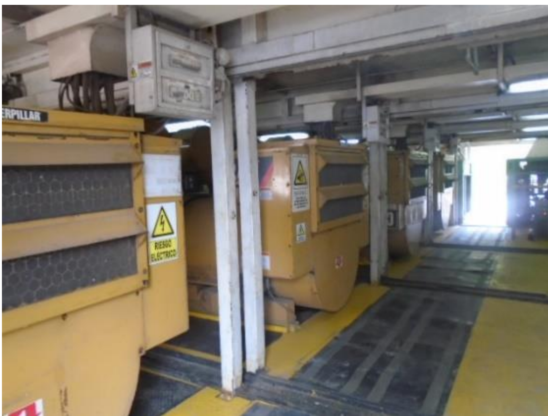
Figura 1. Grupos electrógenos de un taladro de perforación.
