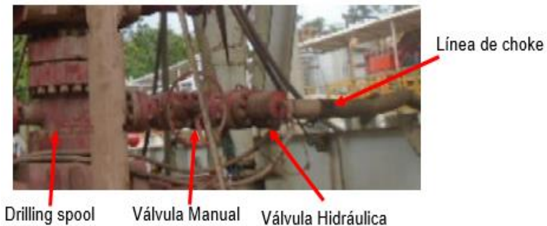
Figura 23. Válvulas de la línea de choke
