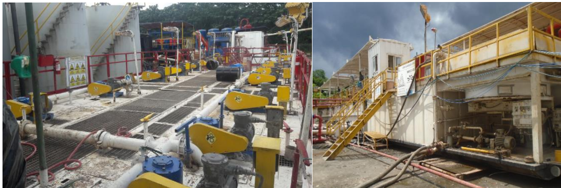
Figura 16. Tanques de lodo de un taladro de perforación.
