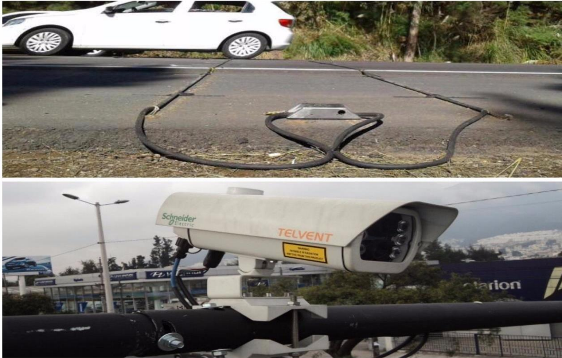
Figura 19. Sensor de presión y cámara de video para contabilizar los vehículos que circulan por la vía.
