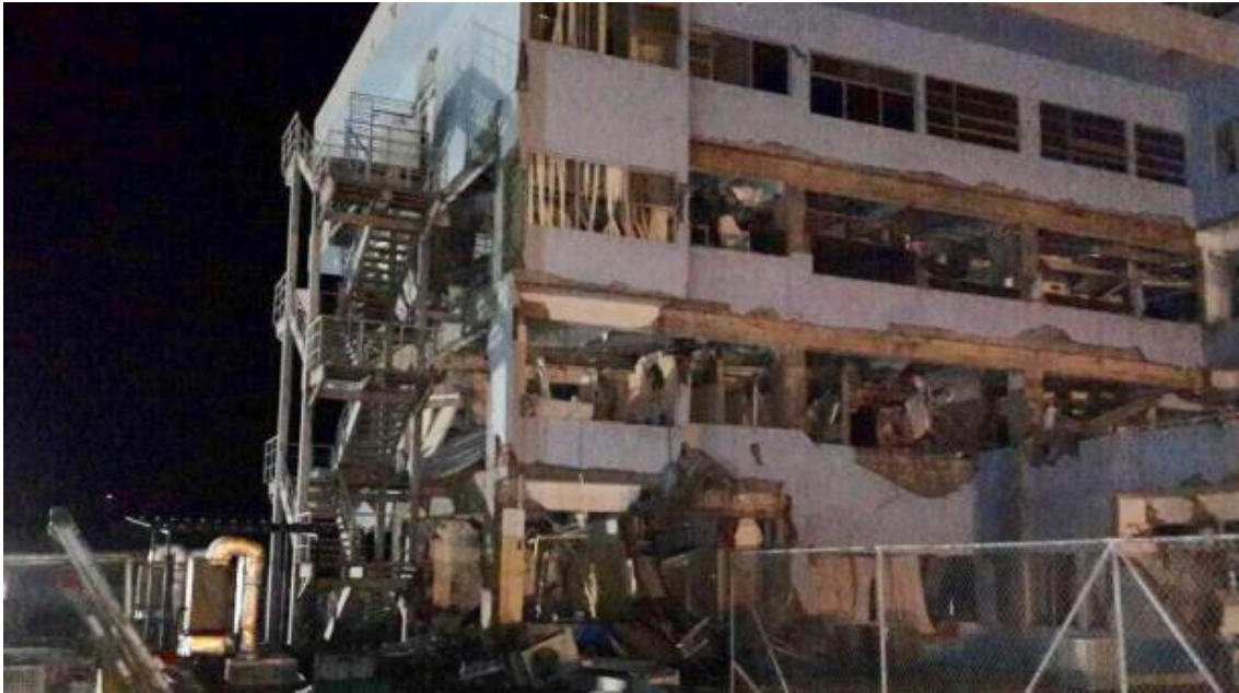
Figura 9. Infraestructura hospitalaria colapsada, áreas de hospitalización ginecológica, quirúrgica, clínica, pediatría y terapia intensiva.
