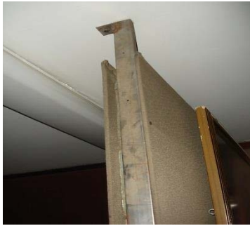
Paneles divisores de oficina que necesita ser cambiado.
