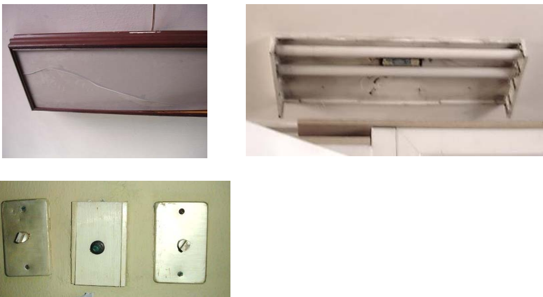
Figura 44. Fotos de luminarias que necesitan mantenimiento e interruptores que necesitan ser actualizados.
