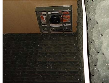
Sistema de ventilación dentro de los cubículos.
