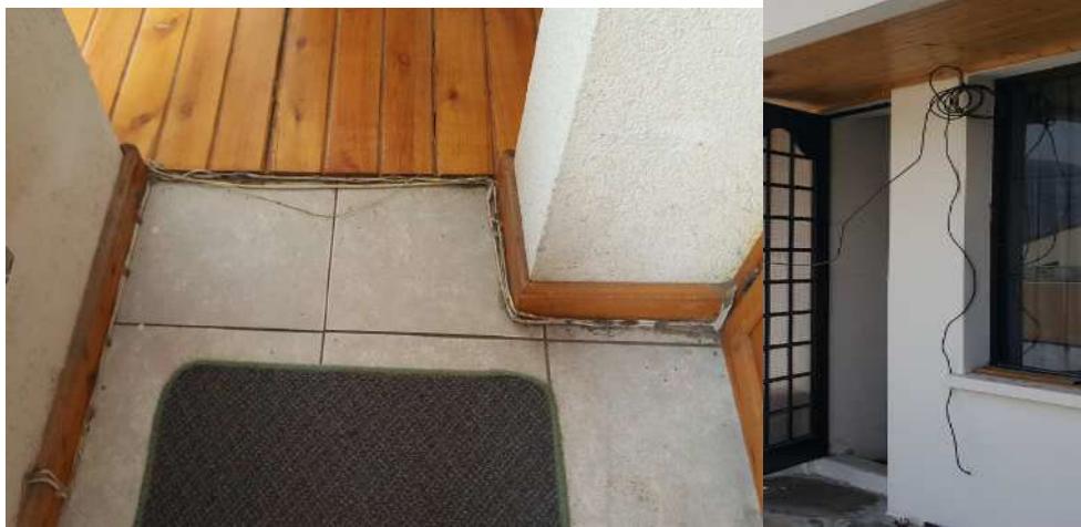
Figura 70. Instalaciones eléctricas expuestas
