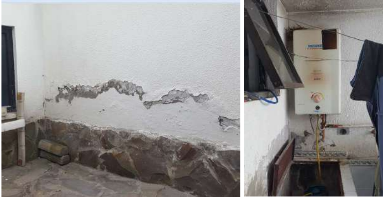
Figura 73. Paredes afectadas por la humedad
