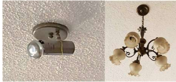
Figura 67. Luminarias con focos halógenos
