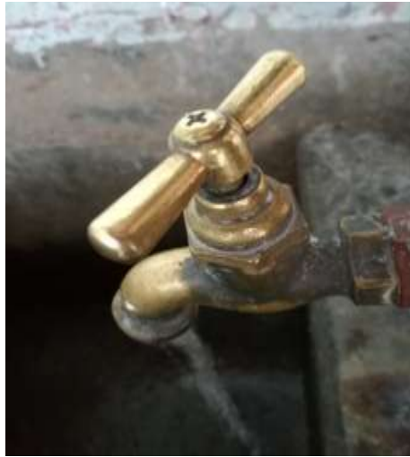
Figura 26 Toma de agua
