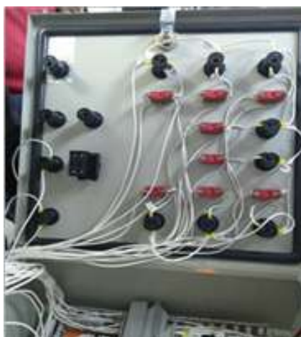
Figura 49 Cableado de cada uno de los componentes de salida
