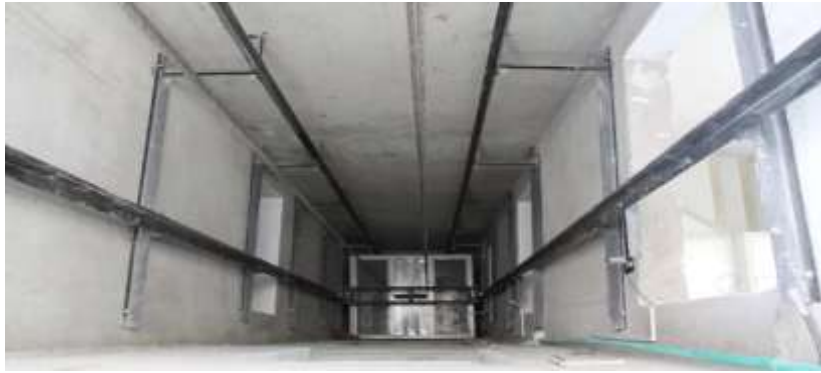
Figura 11 Recinto del ascensor Tomado de: Ascensores y más, (2016)
