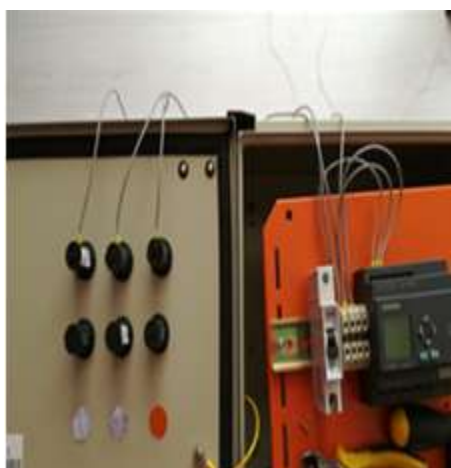
Figura 48 Cableado de los elementos de la Tapa con el PLC
