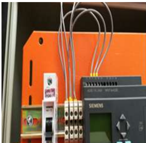
Figura 47 Cableado de los componentes de Control con el PLC
