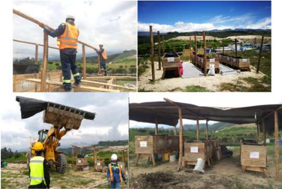
Figura 8. Construcción de la infraestructura para el soporte del techo y colocación del techo.
