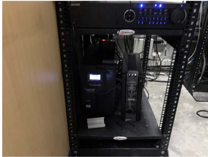
Figura 27. Fotografía del Sistema de respaldo eléctrico del Datacenter.
