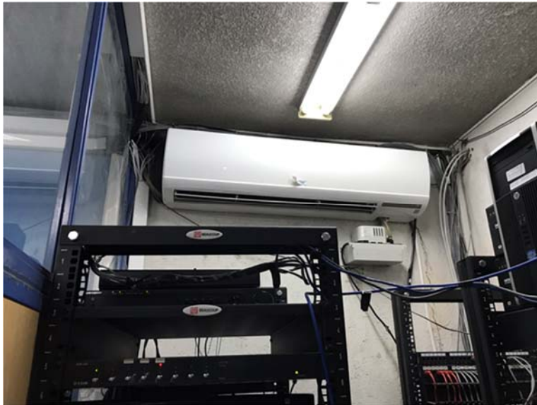
Figura 26. Fotografía del Sistema de enfriamiento de Datacenter.
