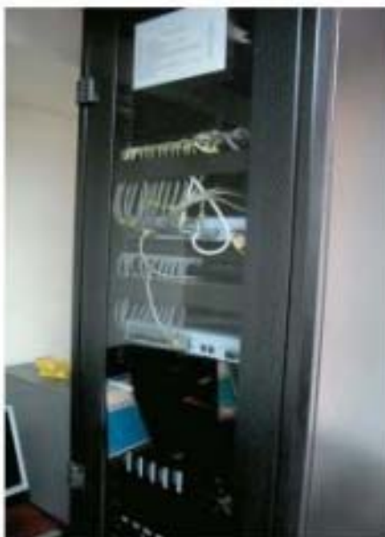
El estándar TIA 942 y la categorización de tiers en Latinoamérica lleva al replanteamiento de las necesidades de infraestructura para la instalación de un datacenter.
