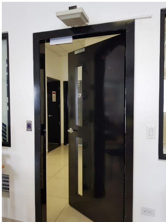
Figura 53. Colocación de Lector -Antena
