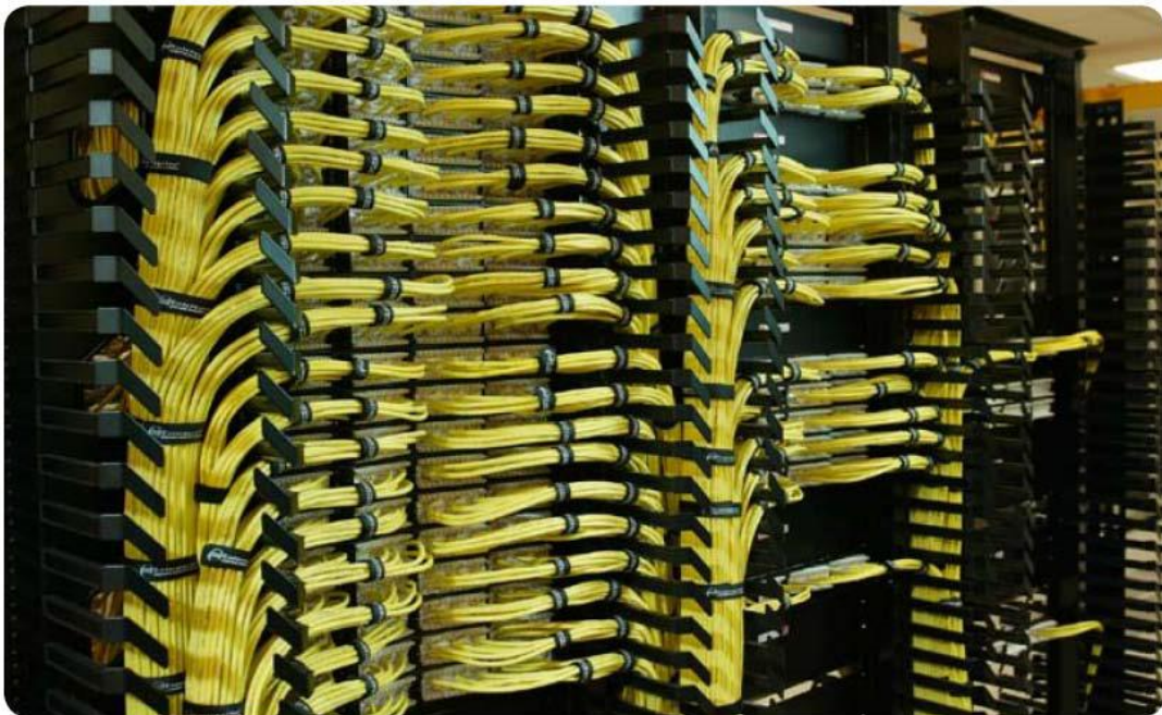
Figura 8: Rack para cable
