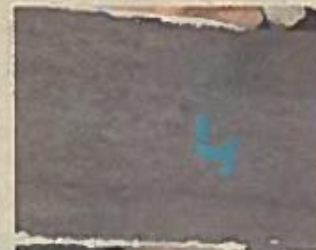
Anexo3. Humedad en la Teja 4 Completamente Húmeda
