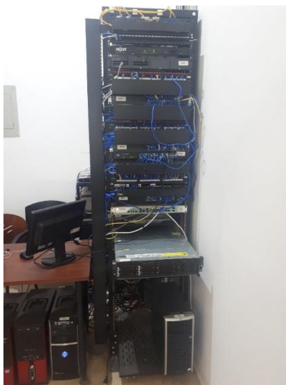
Figura 23. Rack Data Center Rosaprima R1
