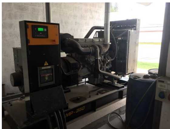
Figura 26. Generador Instalado en Rosaprima R1
