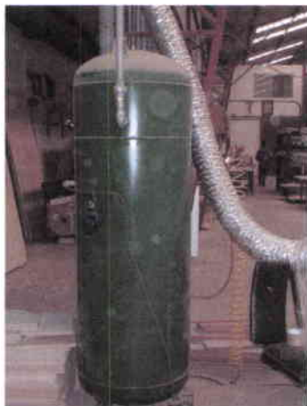
TANQUE DE ALMACENAMIENTO DE AIRE A PRESIÓN
