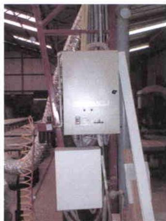
PANEL ELÉCTRICO DEL ROUTER DE CONTROL
