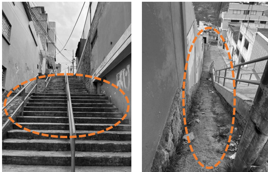
Fotografía 4.- Escalinatas sin mantenimiento Barrio La Tola Elaborado por: John Atencia y Sebastián Yáñez Fuente: John Atencia y Sebastián Yáñez
