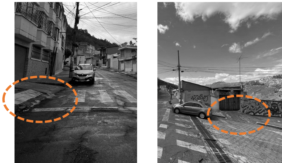
Fotografía 6: Barreras arquitectónicas barrio La Tola Elaborado por: John Atiencia y Sebastián Yáñez
