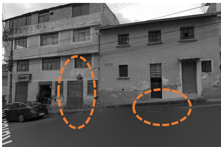
Fotografía 5: Aceras deterioradas barrio La Tola Elaborado por: John Atencia y Sebastián Yáñez Fuente: John Atencia y Sebastián Yáñez
