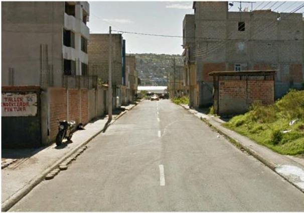
Foto 7 El Estado de la acera es malo, un tramo de la acera no esta construido.
