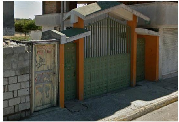
Foto 10 El Estado de la acera es malo, existen puertas que condicionan ingreso a la manzana.
