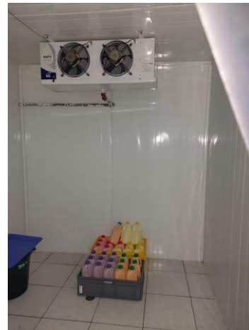
Interior de la cámara de frio
