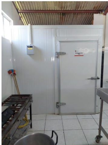
Cámara de Frio
