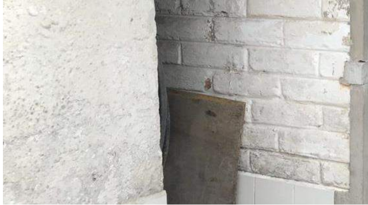
Figura 76 Deterioro de Pintura
