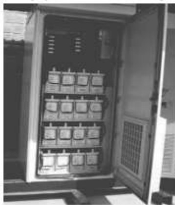
Figura 116 Banco de baterías de respaldo.
