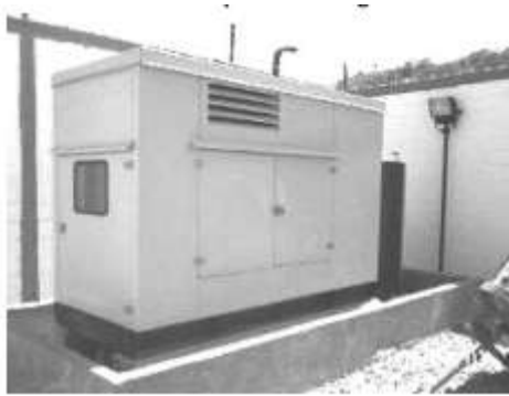
Figura 115 Generador de energía.
