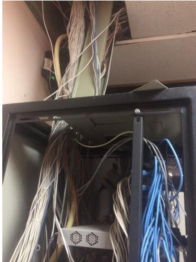
Figura 21. Cableado de datos
