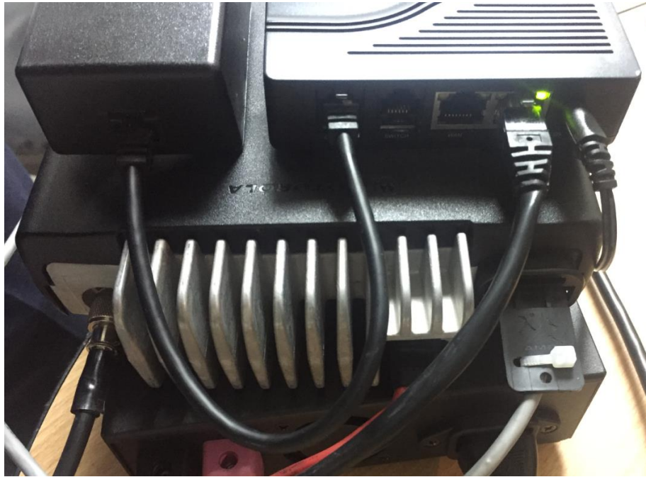
Figura 27. Conexión Gateway Motorola.
