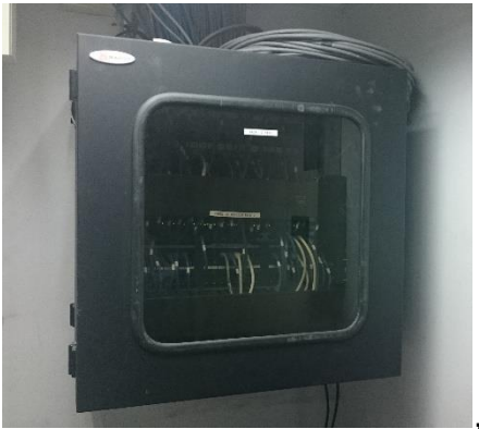
Figura 13. Gabinete de comunicaciones
