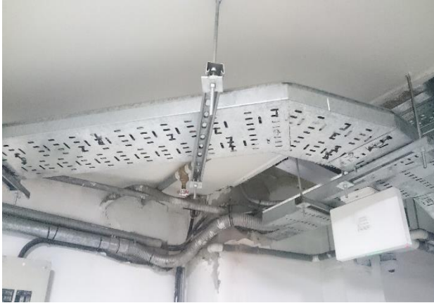
Figura 15. Canaletas metálicas para el transporte de los cables
