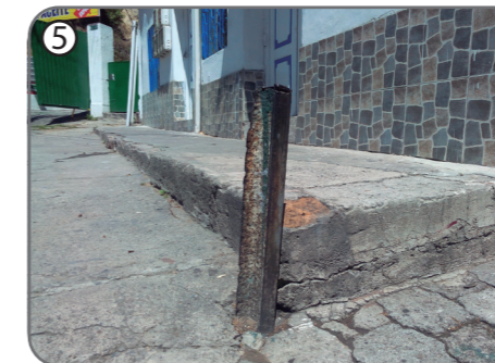
Aceras en mal estado Fuente: Propia, 2015
