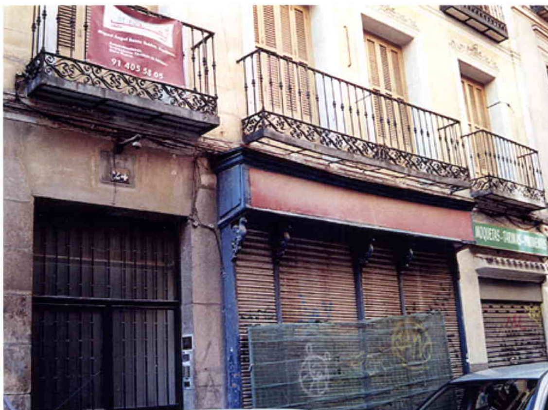
Ilustración 4. Fachada – Estado previo a la actuación – San Marcos 24
