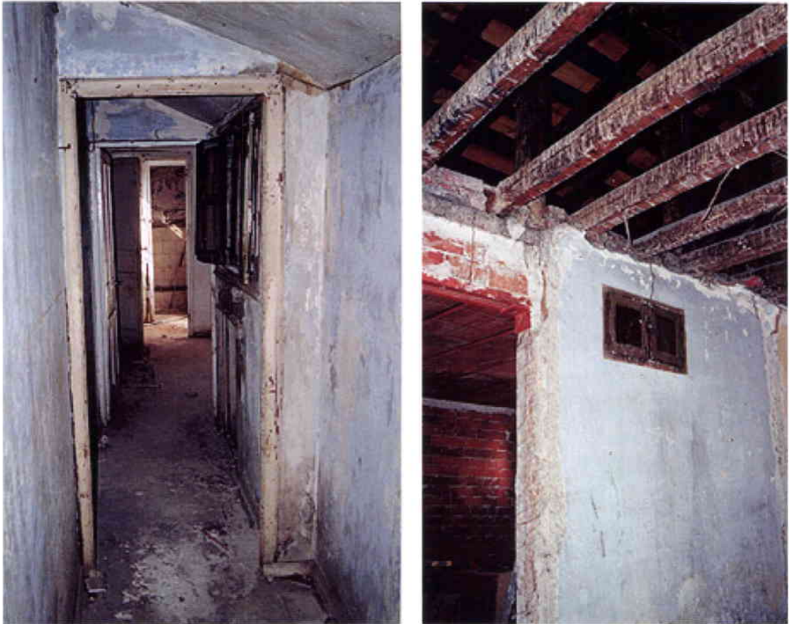
Ilustración 8. Desprendimiento de Cuajados de forjados – Estado previo a la actuación
