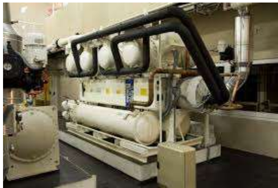
Figura 43: Equipos Frigoríficos Fuente: (Reinoza, 2019)
