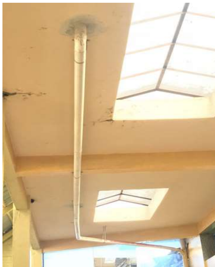
Figura 25: Tuberías en el techo
