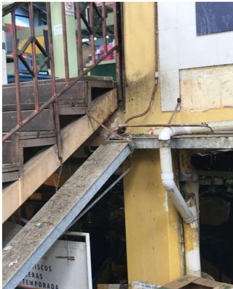
Figura 24: Instalaciones vistas y adaptadas
