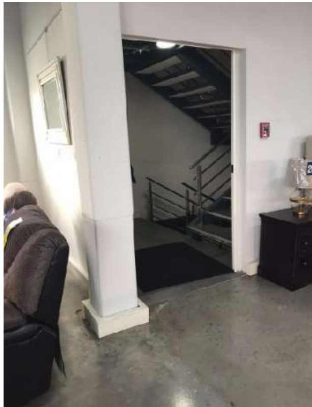
Figura 5. Gradas de emergencia.
